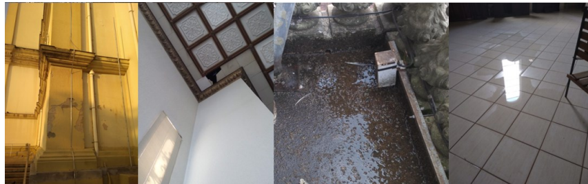
Figura 9 - Problemas causados pelo subdimensionamento das calhas.
