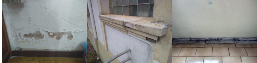
Figura 7. Problemas de Impermeabilização na Fachada Sul.
