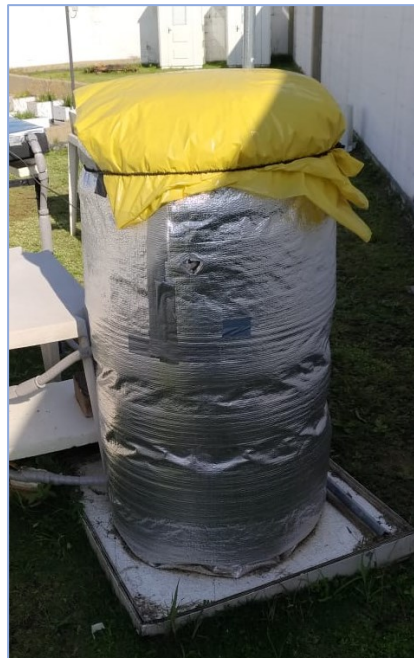
Figura 6 – Depósito de Armazenamento de Água
