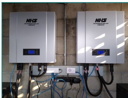
Figura 8 – Inversores bidirecionais e Raspberry Pi 3 instalados
